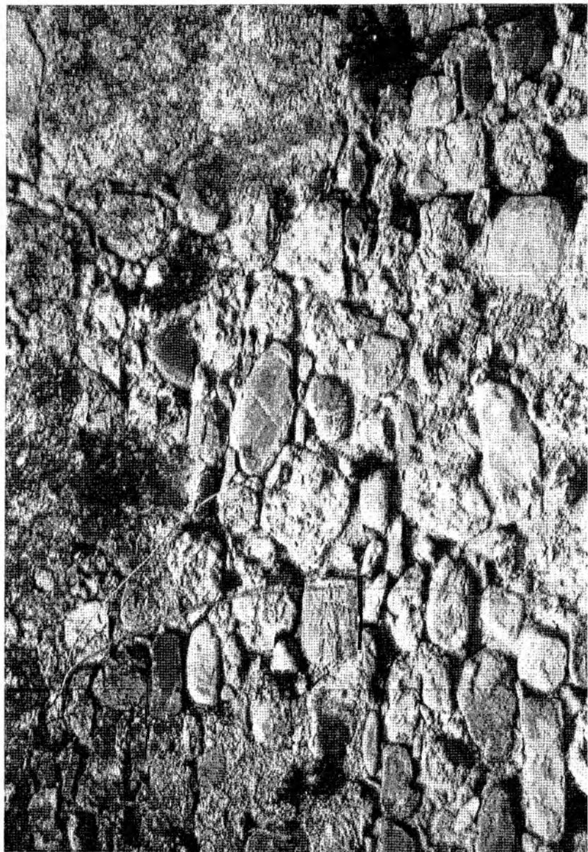
Tav. 30 Particolare relativo al tratto finale della muratura sulla sinistra della porta del Cioussu
