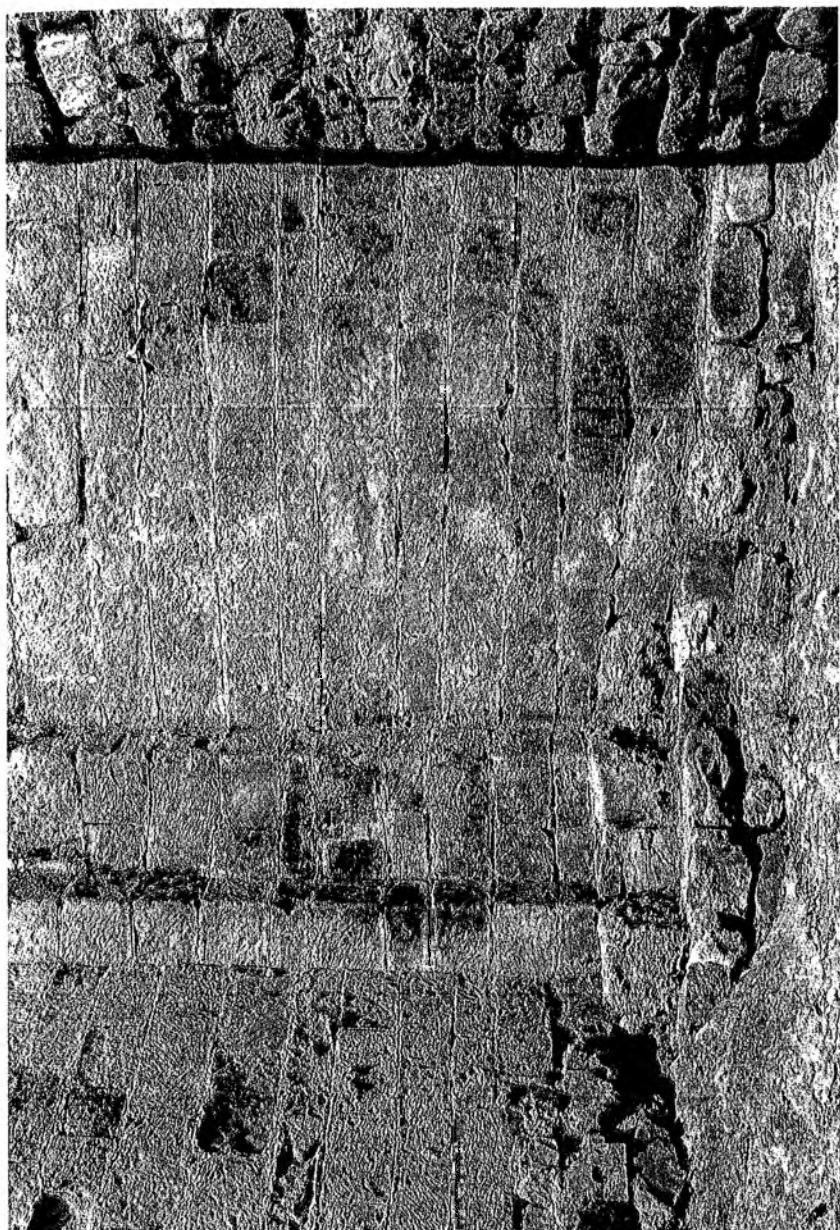
Tav. 3 Particolare relativo all'area absidale della Cattedrale: in basso, muratura del secolo XI; sopra, ricostruzione tardo romanica in conci di pietra calcarea perfettamente squadrata (prima metà XIII secolo)
